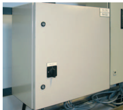
Силовой шкаф РК100
